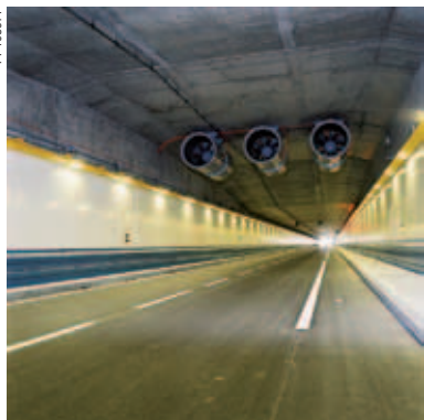
Aplicación de purificación de aire
