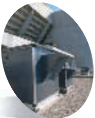
Ventilatoren: Klimatechnik Sicherheit/ Rauchabzug
